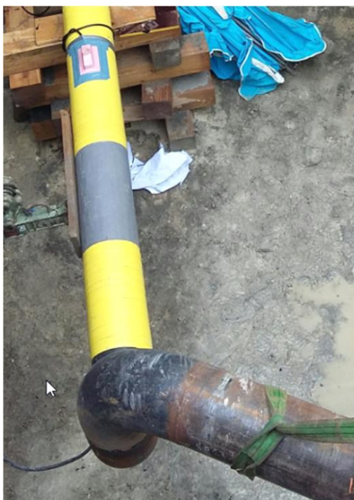
Canalisation en acier © GRDF
