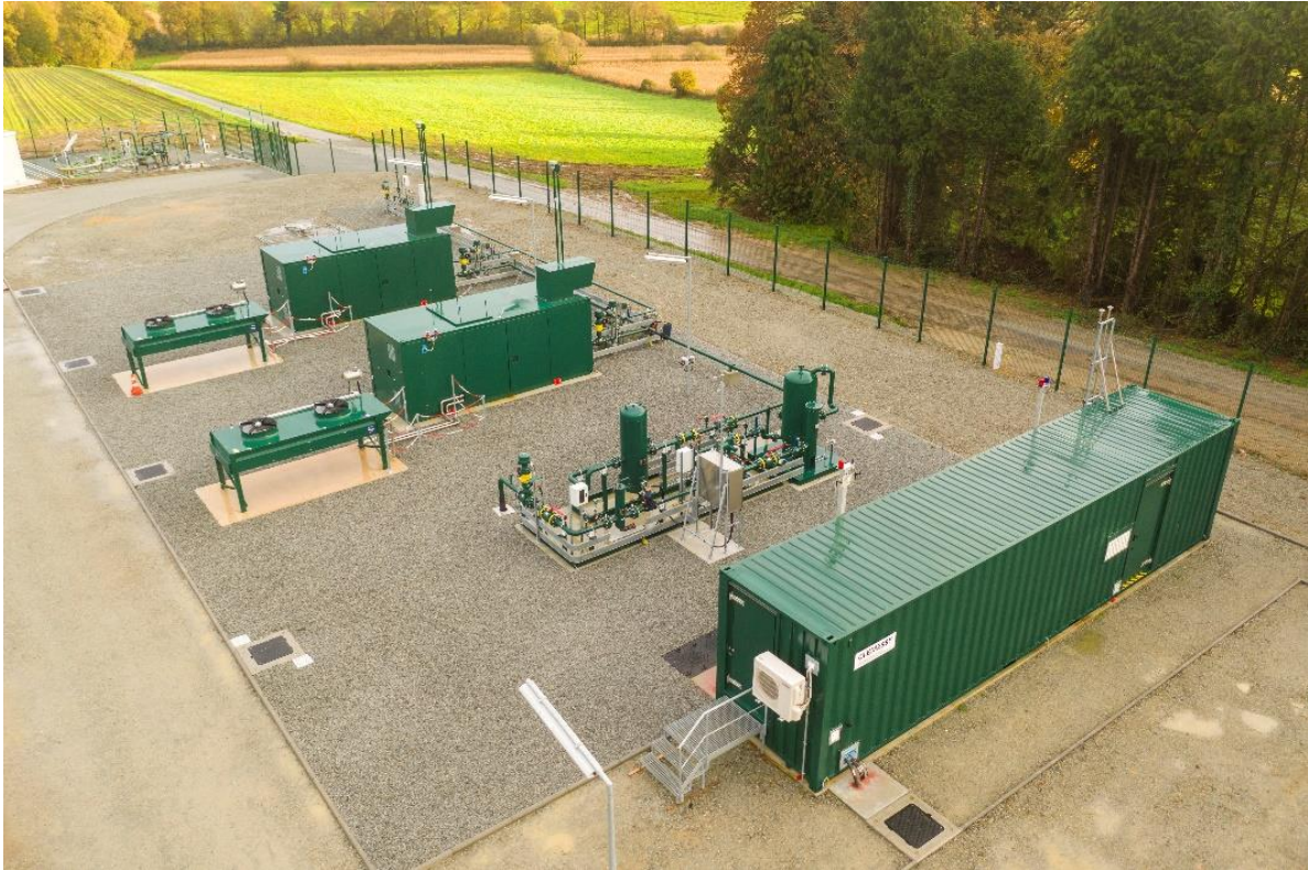
Poste de rebours de Noyal (35) © GRTgaz
