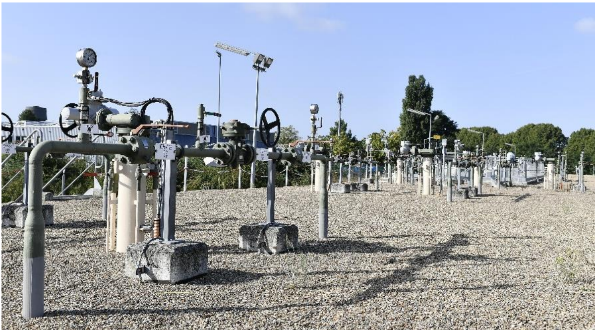
Poste de détente © GRTgaz
