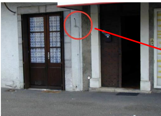
Robinet situé en façade © GRDF
