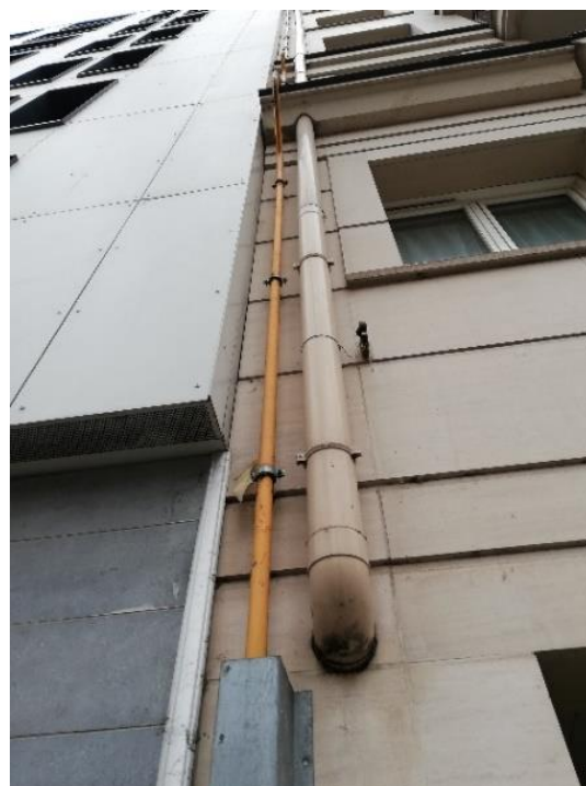
Tuyauterie de gaz sur façade © Christophe Perdriset - DGSCGC
