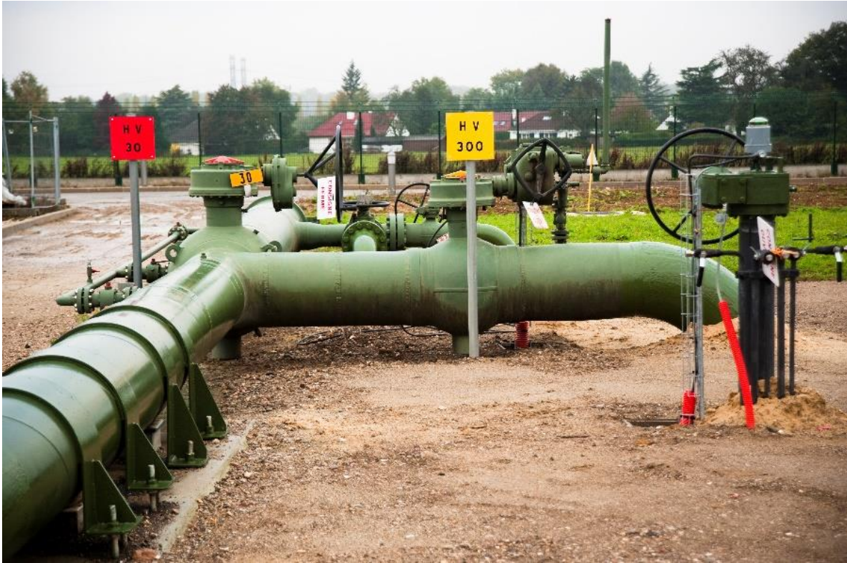
Station d'interconnexion de Férolles-Atilly (77) © GRTgaz
