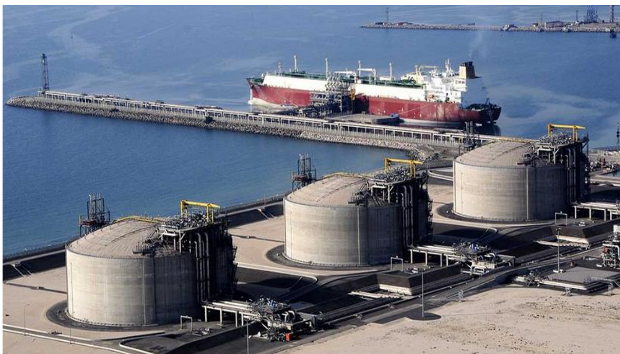
Terminal méthanier de Fos Cavaou à Fos-sur-Mer © Gaz-Mobilité
