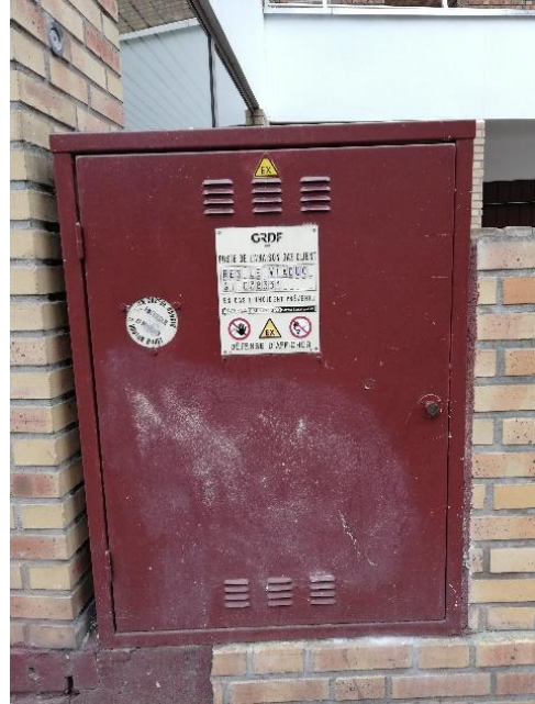
OCG en façade de bâtiments © Christophe Perdriset – DGSCGC
