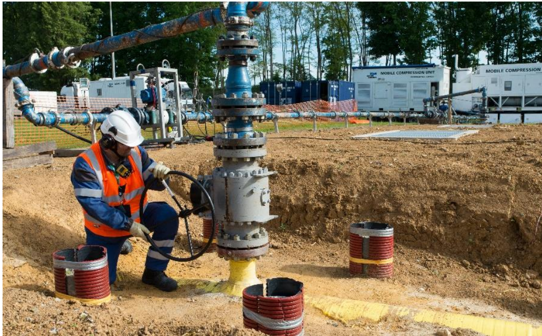
Opération de gas booster en Seine-et-Marne © GRTgaz
