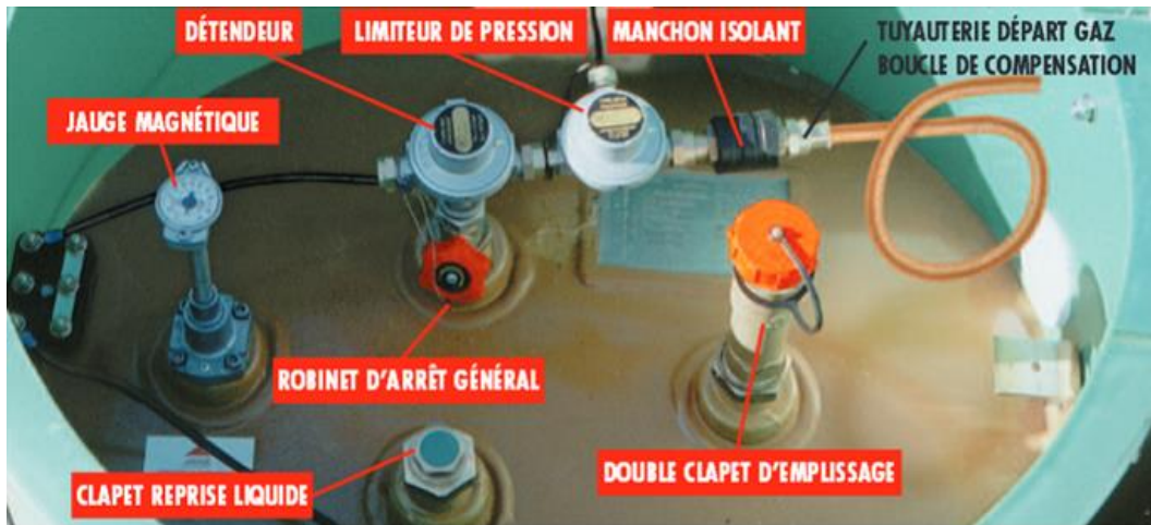
Organe de coupure (robinet d'arrêt général) sur une citerne enterrée. © www.vitogaz.com
