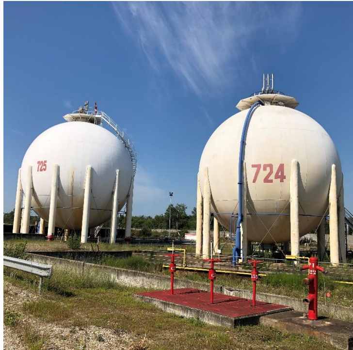
Sphère de GPL site de Feyzin (69) © Total Energie
