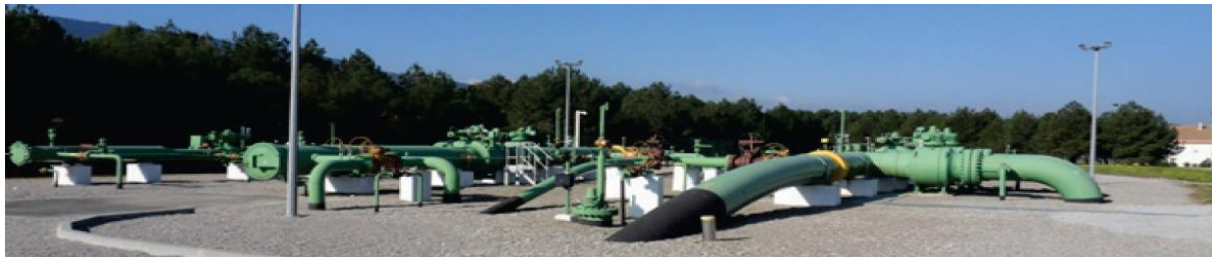
Poste de sectionnement © Teréga
