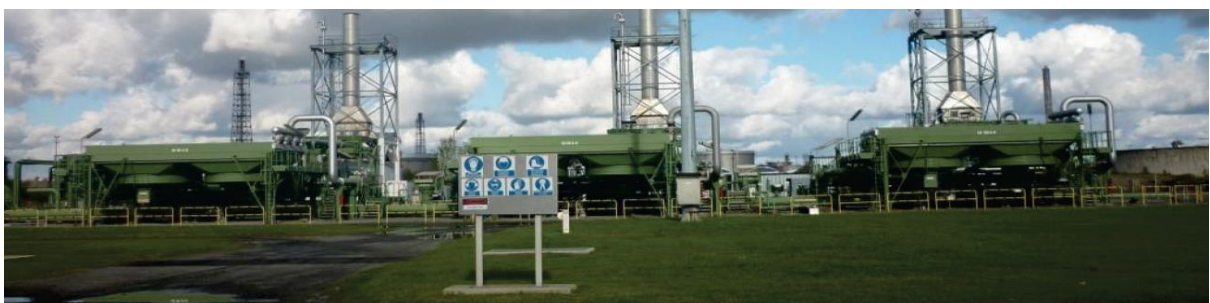
Station de compression © Teréga
