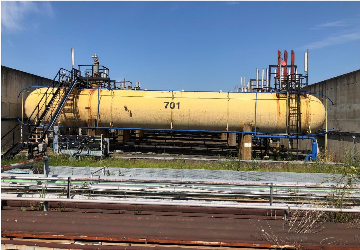
Sphère de GPL site de Feyzin (69) © Total Energie
