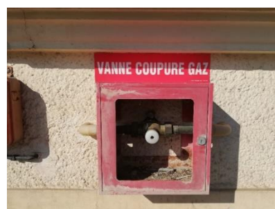
Vanne de coupure d'une chaudière fonctionnant au gaz © christophe Perdrisot - DGSCGC
