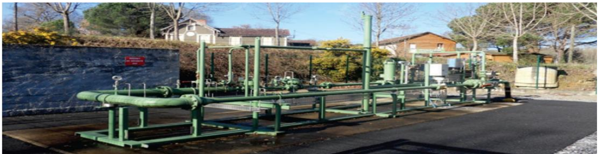
Poste de livraison © Teréga
